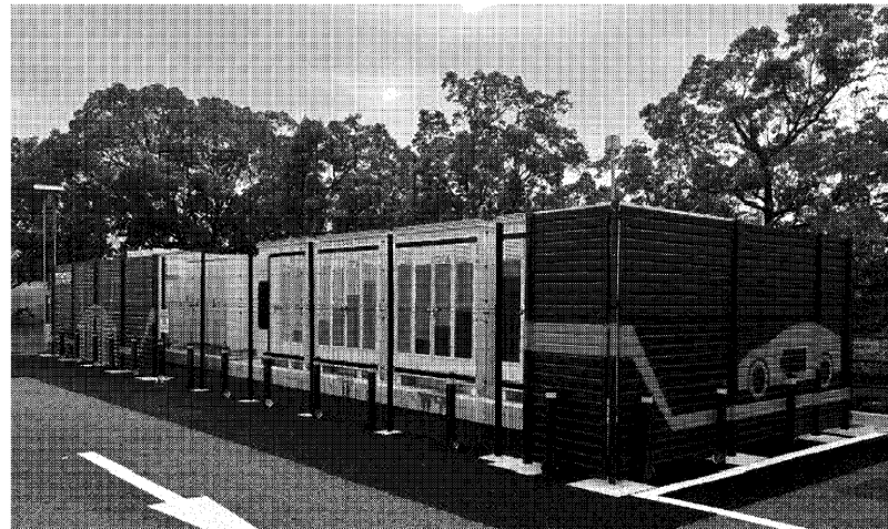
豊田スタジアムに設置したEV電池を使用した定置用蓄電池システム
