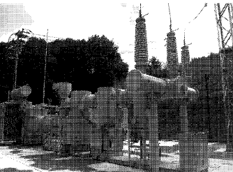
66kV~220kV 受変電設備
