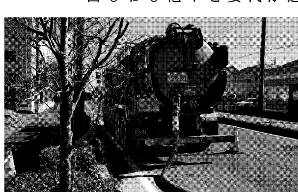
埼玉県八潮市道路陥没事故の際にはバキュームカーで汚水を運搬した
