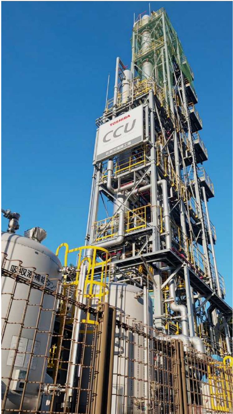
CO 2 分離・回収設備。ゴミ焼却排ガスからCO 2 を日量10トン回収
