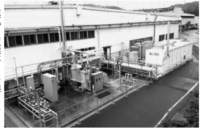
水素ボイラ(手前)と水素製造装置「やまなしモデルP2Gシステム」
