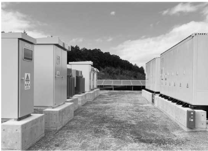
熊本県大津町で連系調整中の蓄電池
