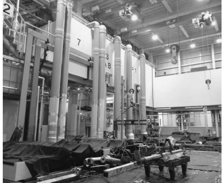
東洋硬化が本社工場内で稼働させた新棟
