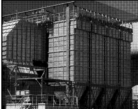
バグフィルタ式集塵機
