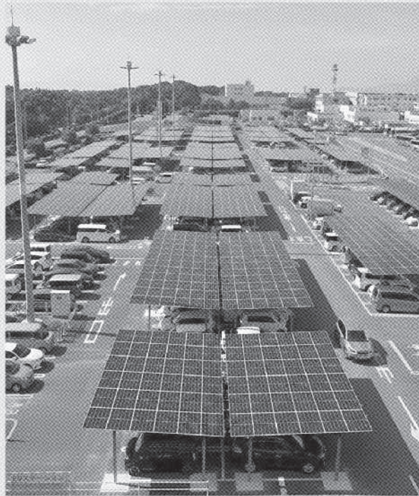
阿蘇くまもと空港の駐車場に設置した合計1100枚のカーポート型太陽光パネル
