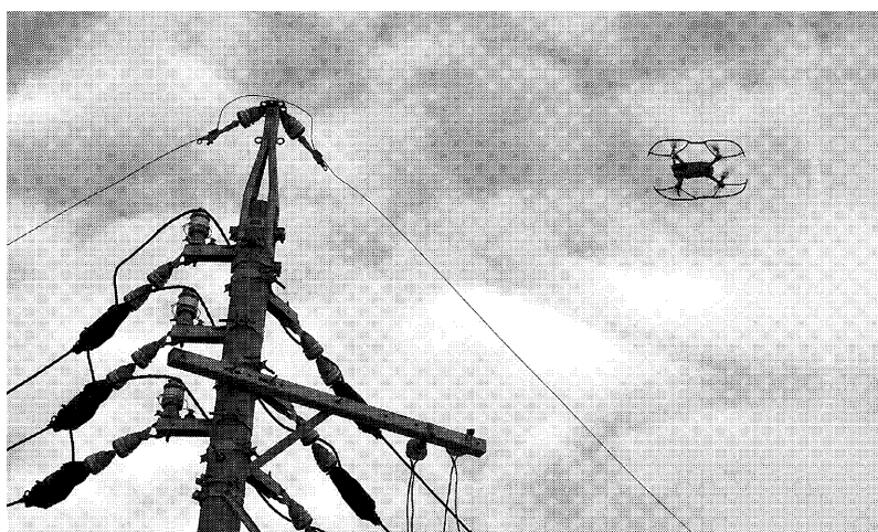
ドローンを利用し設備異常を発見して被害拡大防止、早期復旧につなげる
