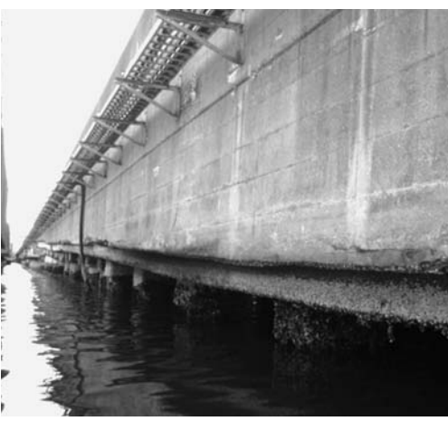
東品川橋は桁下と海面が近いので維持管理が困難(首都高速道路提供)
