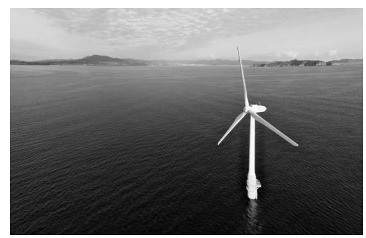
長崎県五島市・福江島沖で稼働中の浮体式洋上風力発電(戸田建設)
