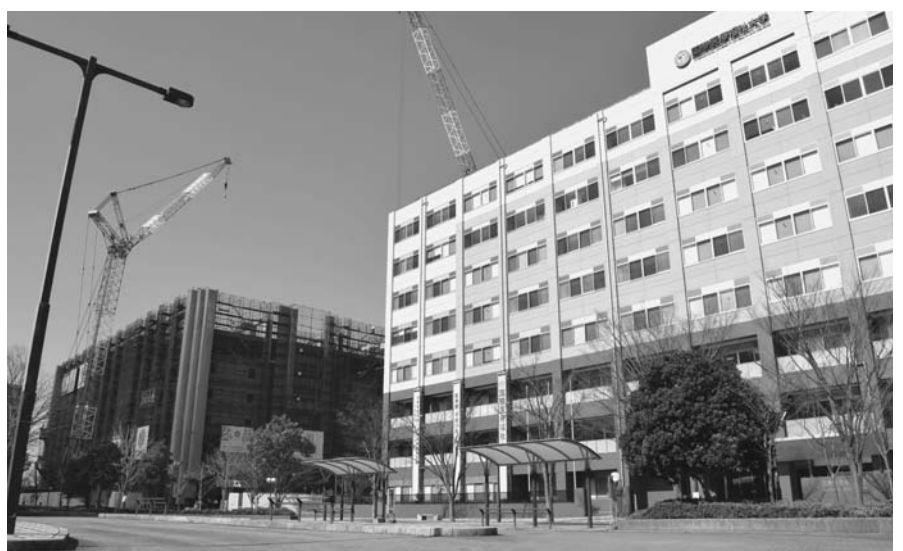
国際医療福祉大学では医学部キャンパス棟の工事が進む
