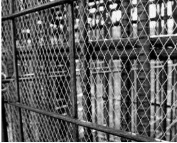
ラス型枠。この網目が打設されたコンクリートを支える
