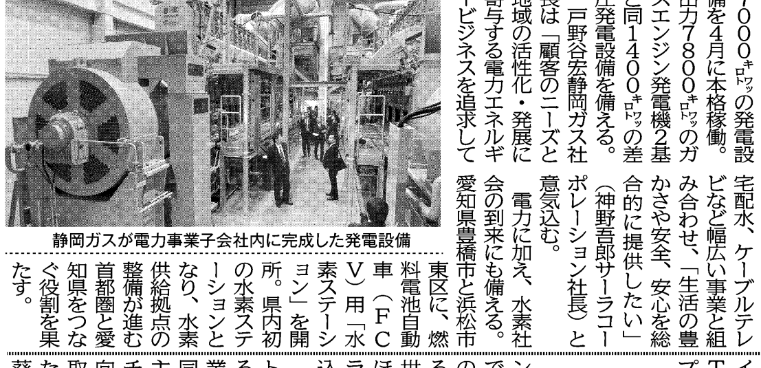
静岡ガスが電力事業子会社内に完成した発電設備
