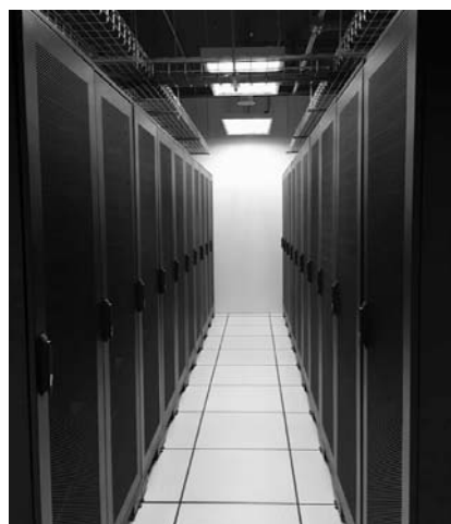
マレーシアのデータセンター(日立サンウェイ)
