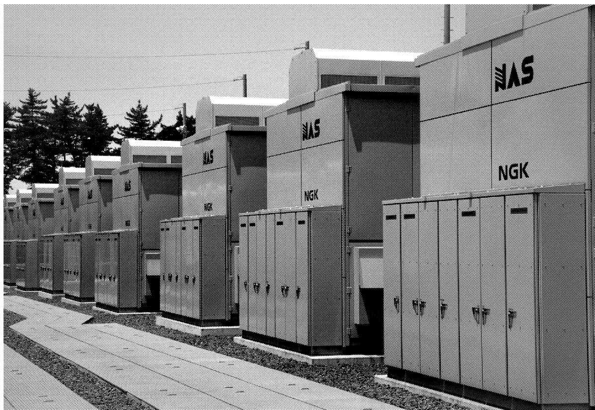
3万4000キロワットNAS電池 (六ヶ所村二又風力発電所)
