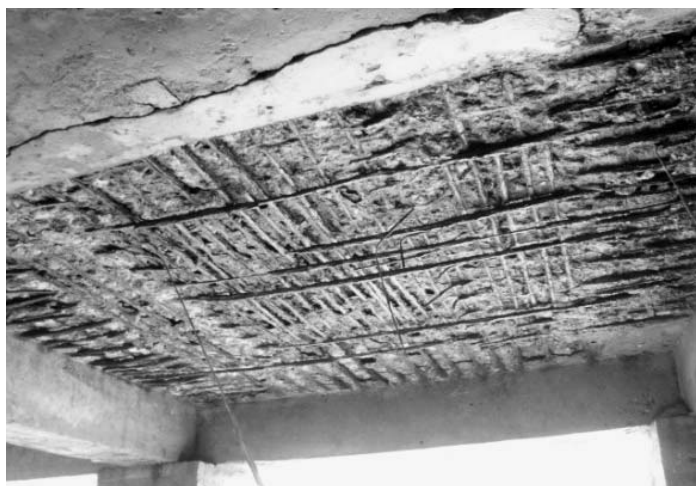
コンクリート構造物の塩害事例
