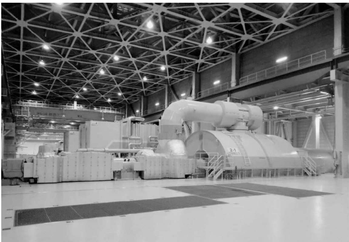
中部電力が7月に運転開始した上越火力発電所「2-1号」発電機
