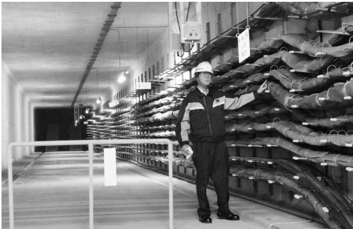
N T T 西日本が公開した光回線の地下道「洞道」
