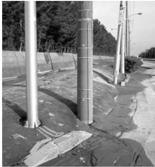
写真2 突き上げた歩道
