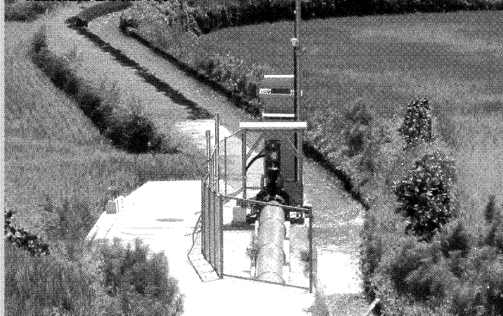
小水力発電 城原井路発電所(竹田市)
