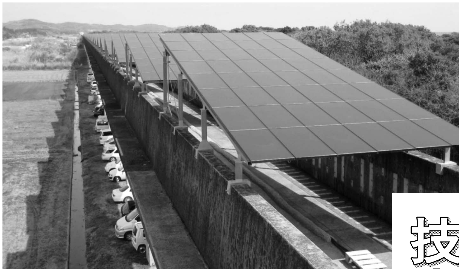
国際航業ホールディングスは宮崎県都農町に大規模太陽光発電所を完成した
