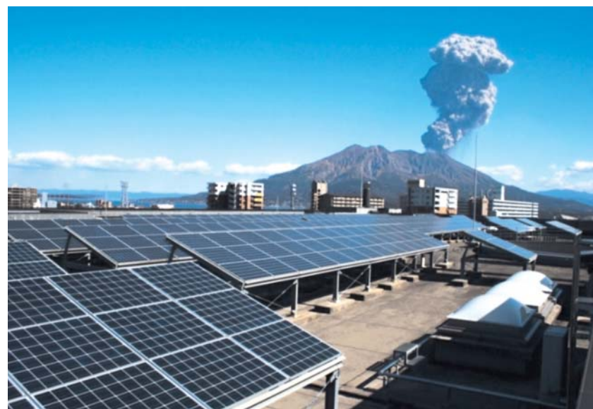
出力100キロワット規模の太陽 発電システム(かこしま 県民交流センター)
