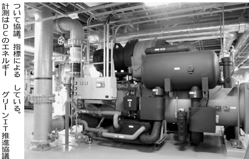
グリーンITにはDCの省電力化が必要(上)日立製作所のデータセンター内(富士通の館林データセンター冷却設備)
